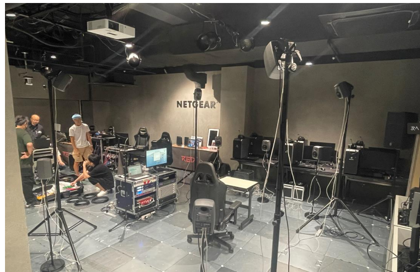
ライブ配信時の仮設のDolby Atmos MIXブース
