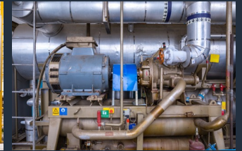
コンプレッサー
