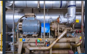
コンプレッサー
