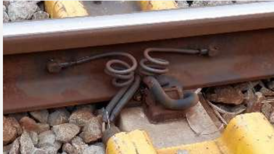
電気設備B
